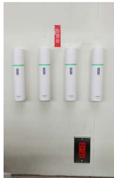
◀庁舎の壁に設置された常備灯(上)と非常用コンセント(下)
