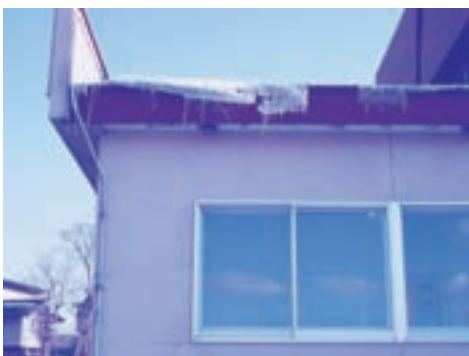
【 危険箇所 ~ 雪の落ちそうな屋根 】
