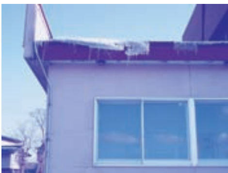
【 危険箇所 ~ 雪の落ちそうな屋根 】
