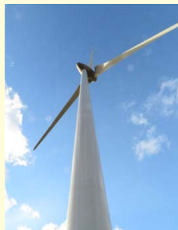
下から見上げた風力設備 先端まで約120m
