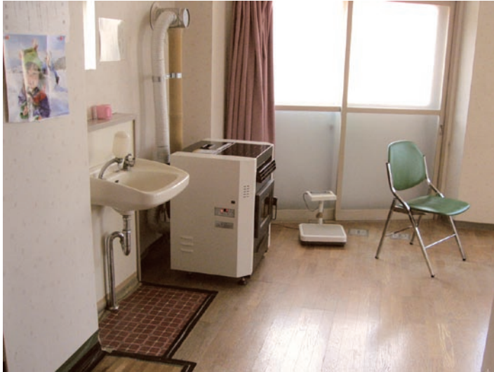
福祉センター脱衣所に設置されているペレットストーブ
