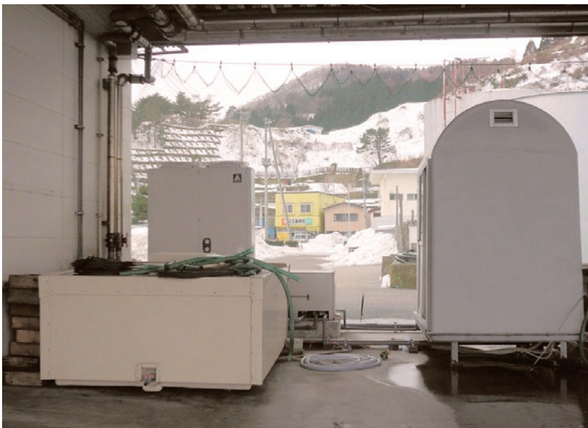
小泊漁協に設置された海水ろ過殺菌装置
