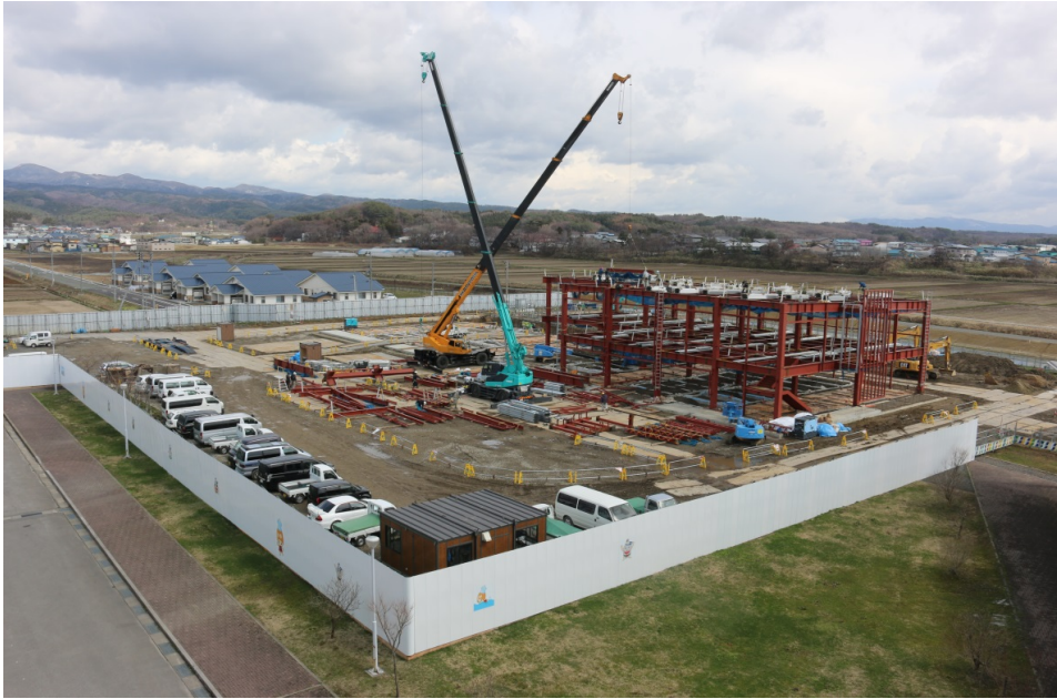
2016年4月11日 新庁舎建設現場全景 (庁舎棟の約半分の鉄骨を 組み終わっています。)
