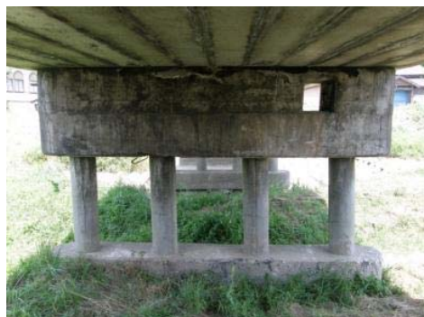
飛石橋 橋脚梁にASR
