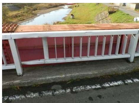
今泉橋 防護柵の縦棧が消失
