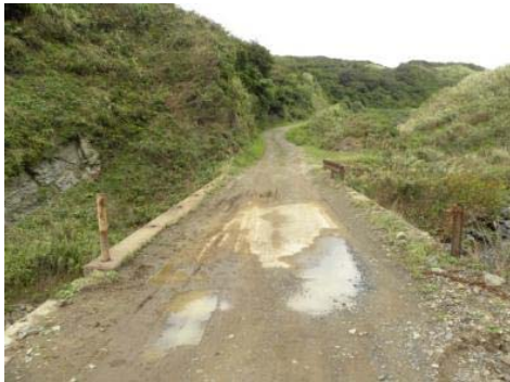
松陰橋 防護柵の損失
