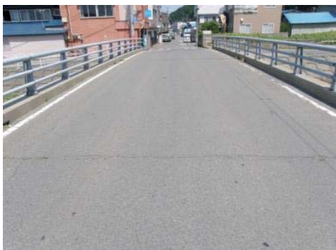
薄市橋 伸縮装置部に段差
