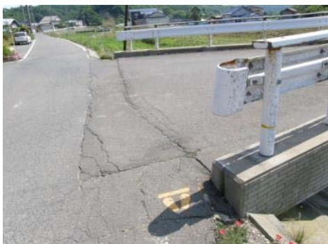
飛石橋 伸縮装置部に段差
