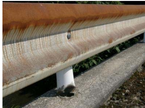
蛭沢橋 防護柵支柱基部欠損
