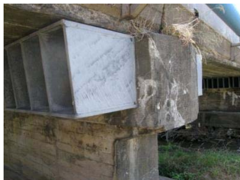
薄市橋 橋脚にASR損傷
