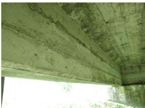
北小泊山国有林1号橋 主桁、床版の塩害
