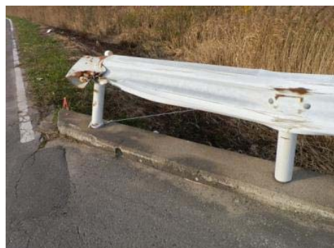
中里川橋 防護柵の変形
