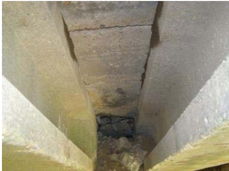
1031橋 床版に剥離、鉄筋露出
