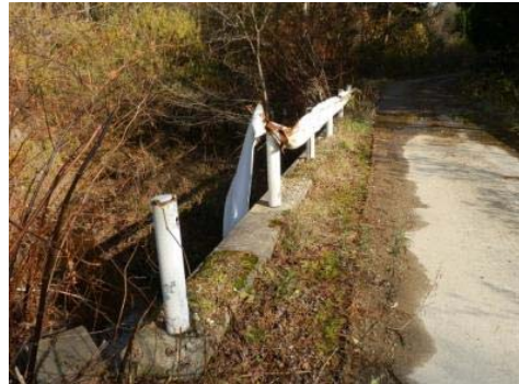
仲の股橋橋 防護柵ビーム逸脱
