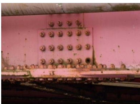
今泉橋 主桁添接版のボルト抜落ち
